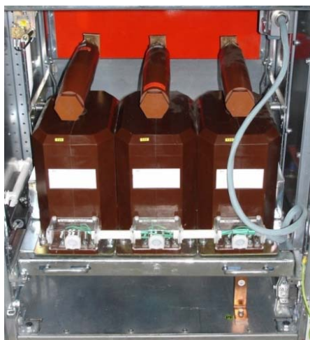
Rys. 6. Przekładniki napięciowe w polu pomiarowym
