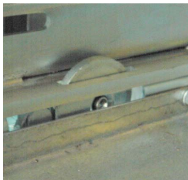
Rys. 14. Element mechanizmu blokady zamknięcia uziemnika gdy człon wysuwny jest w położeniu ‘praca’
